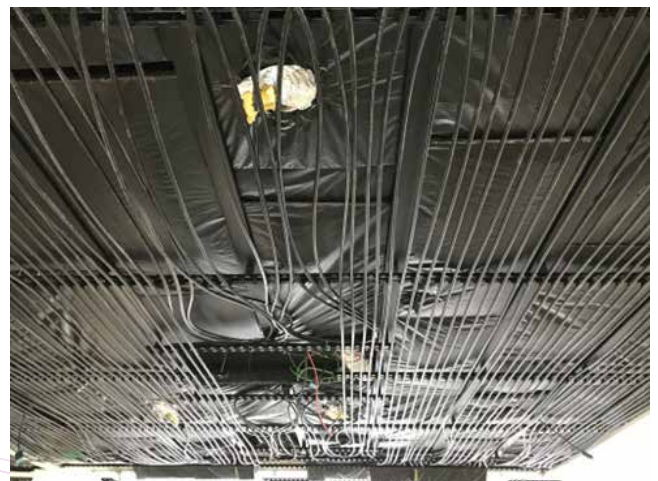
Verwarmingsleidingen aan het plafond met isolatie erboven.
